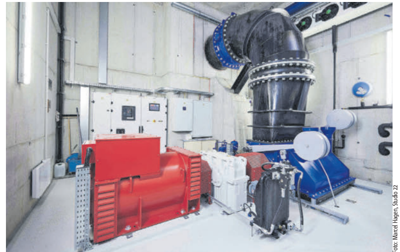
Der gesamte Stromverbrauch aller Getzner-Unternehmen wird aus eigener Wasserkraft gewonnen – umliegende Gebäude (z.B. das Val Blu) werden mit Fernwärme versorgt.
